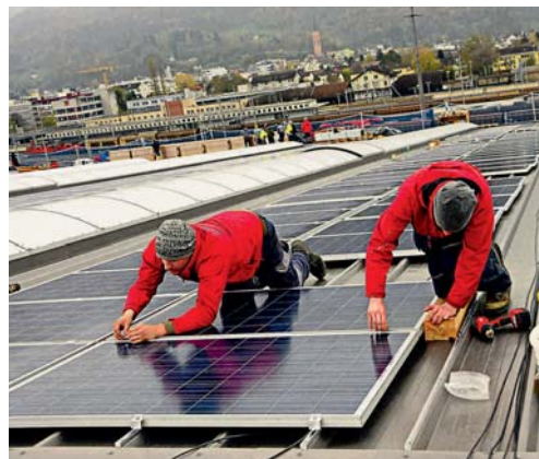
Pionierprojekt wird realisiert: Insgesamt 20 Mitarbeitende des EW Buchs leisteten dazu am Samstag einen freiwilligen Einsatz.
