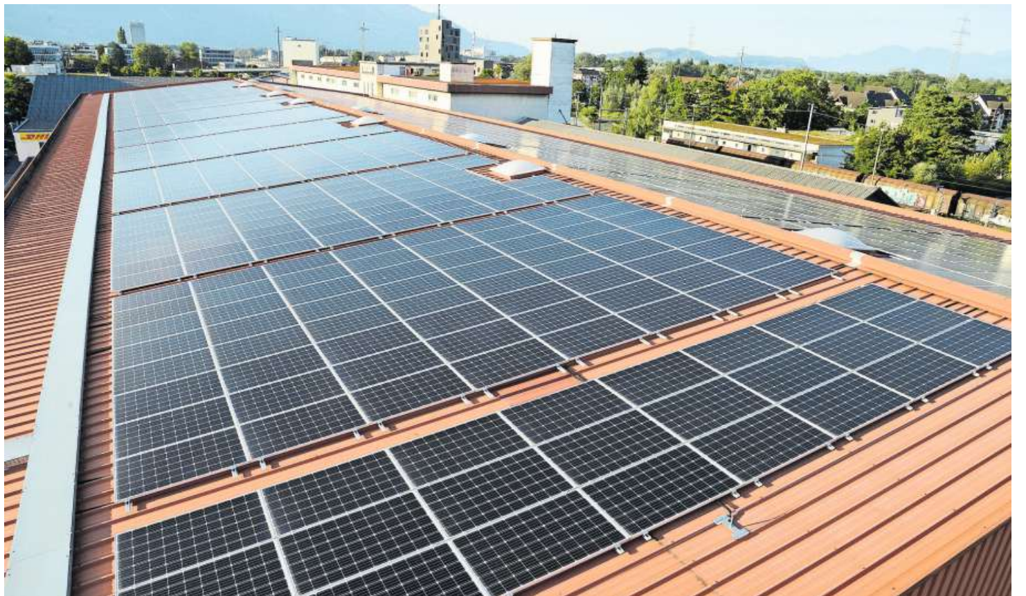
Die neue Fotovoltaikanlage auf dem DHL-Satteldach wird jährlich rund 370 000 kWh Energie produzieren.
