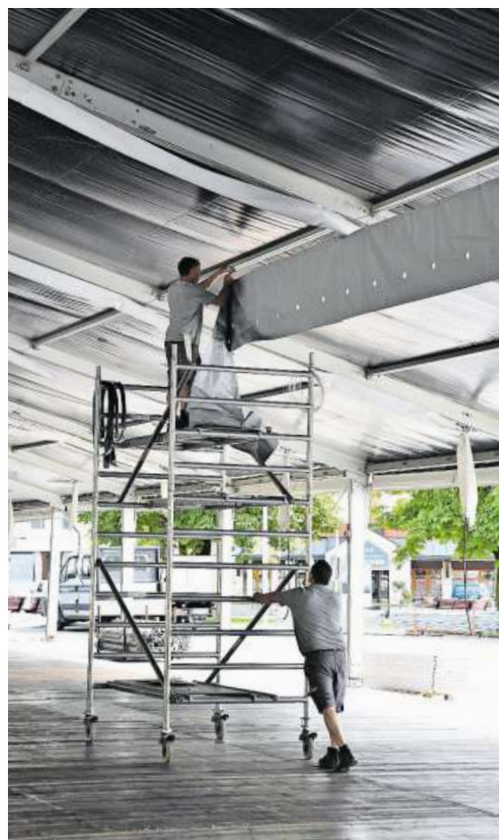
Heizungstechniker hängen am Mittwoch die «Rohre» für die Heizung ans Dach des Eventzelts.
