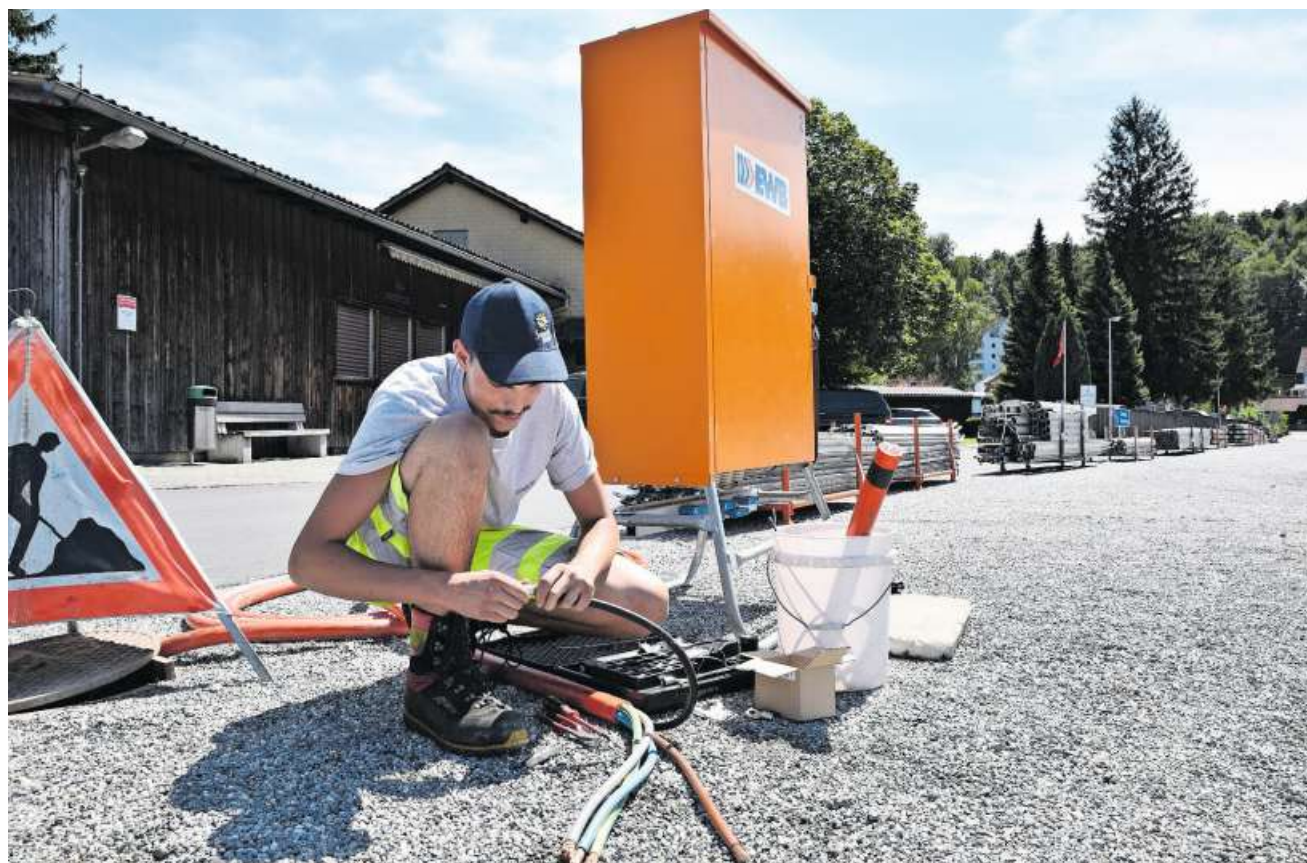
Ein Mitarbeiter des EWB bereitet am Montag die elektrischen Leitungen und Anschlüsse vor.
