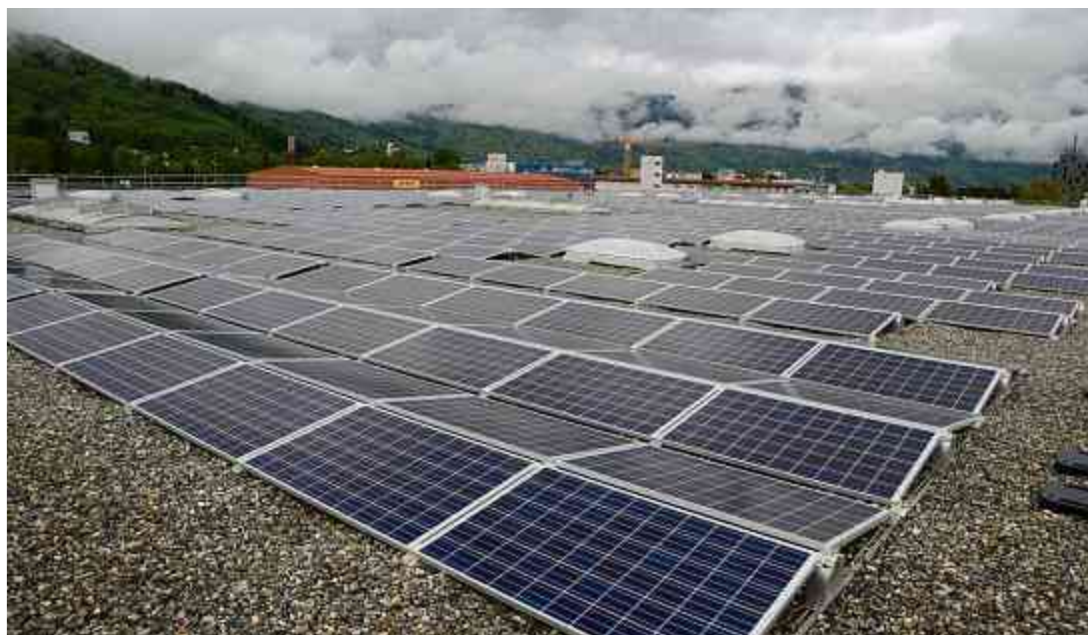
Am Samstag konnte die Photovoltaikanlage auf dem Dach der Industriehalle an der Lagerstrasse eingeweiht werden. Die zurzeit grösste Anlage dieser Art in Buchs besitzt 3040 Solarmodule und produziert rund 773 000 Kilowattstunden pro Jahr. Bild: Hansruedi Rohrer ▶ LOKAL 11
