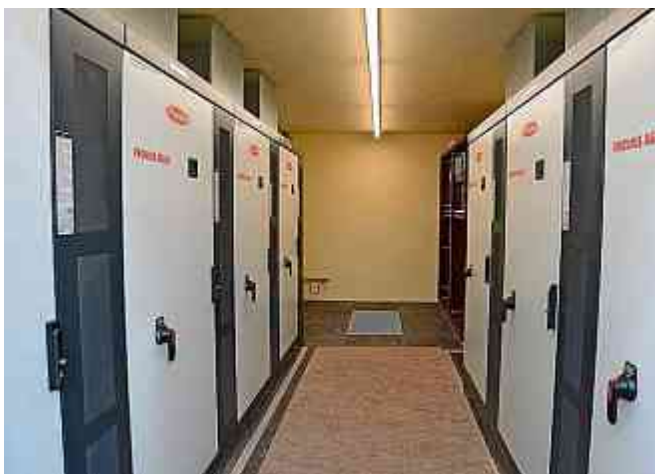
Blick in die Wechselrichterstation, ab hier fliesst die Energie ins Netz.
