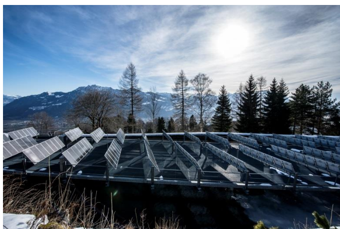
Bereits vom EWB betriebene Anlage am Vorderberg (Bild Peter Fuchs)
