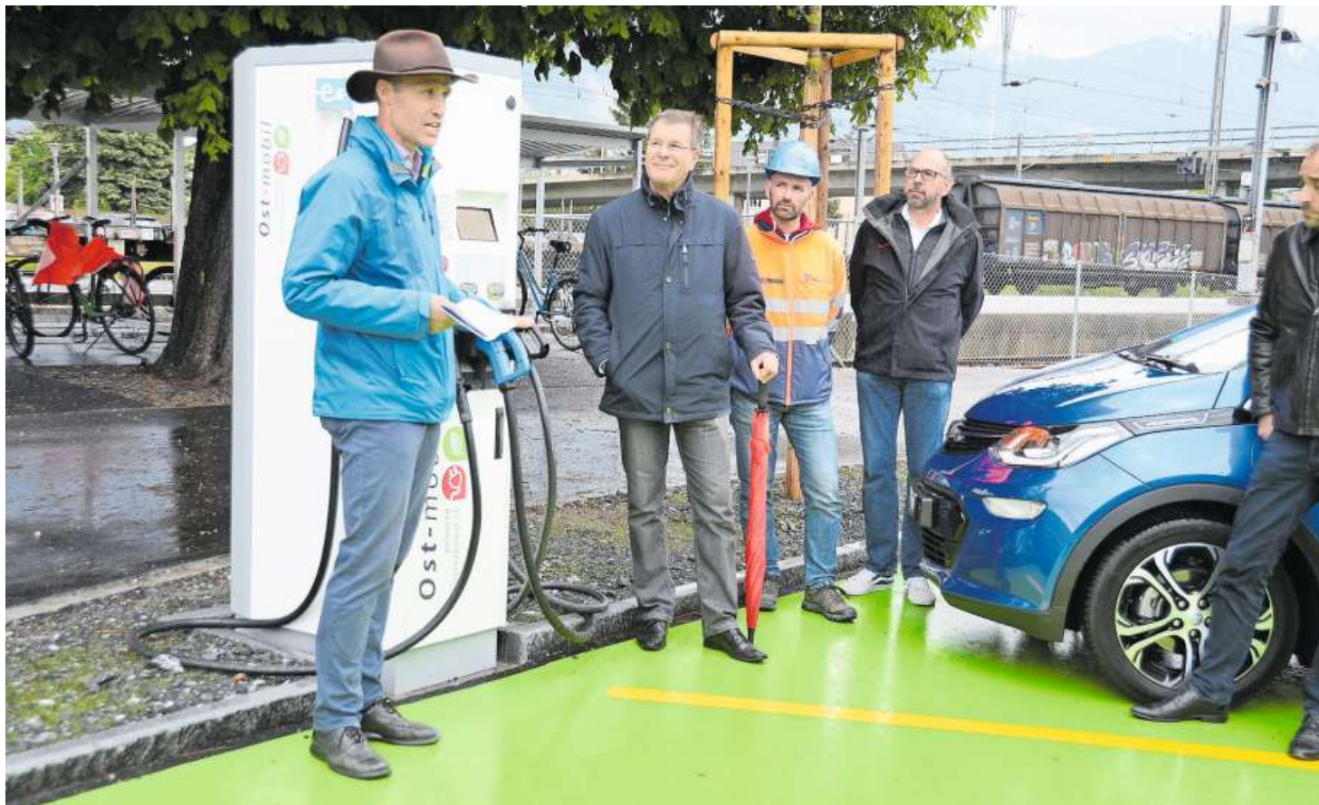
Jürg Göldi (links), Bereichsleiter Infrastruktur beim EW Buchs, demonstrierte das Laden eines Elektrofahrzeuges an der neuen Ladestation.
